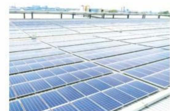
▲ 光伏发电装置
