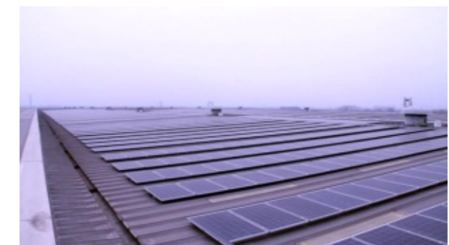
光伏发电装置
